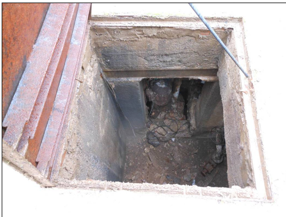
Foto 4: Dependència subterrània per al control de les aigües subterrànies.
